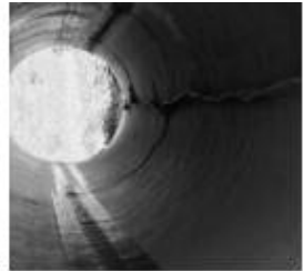
c. Arruga longitudinal.
