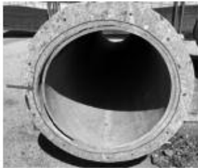
a. Manca de contacte en mànegues semiestructurals i sense preliner.
