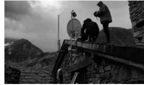
Figura 2. Instal·lació d'una estació de mesura HD-RAIN per a la detecció de la precipitació a la borda de Sorteny. Font: AR+I
